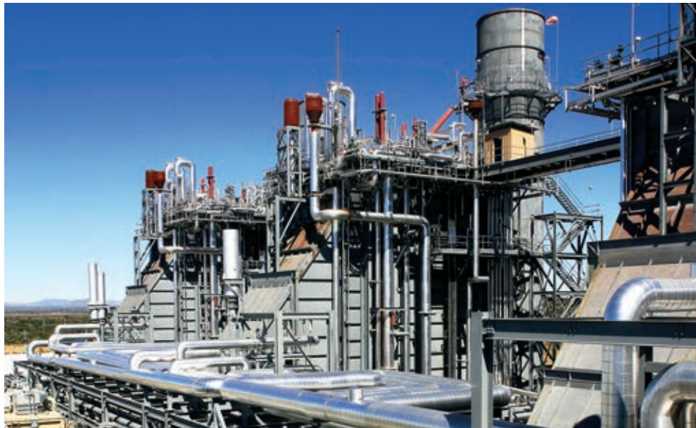
Central eléctrica, México.
